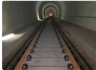
System IVES mit DFF 300 RS im Zierenbergtunnel
