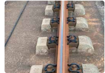
Strecke Köln / Rhein-Main Abschnitt Bad Camberg – System 300-1 mit Spannklemme M3
